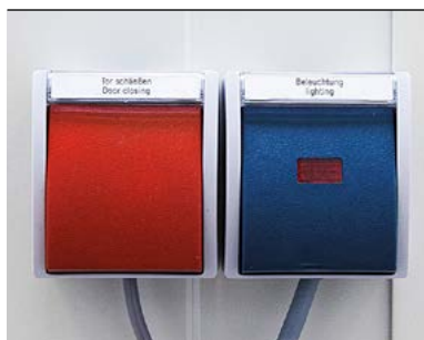
Interruttore per illuminazione e pulsante per impianto fermo porta
